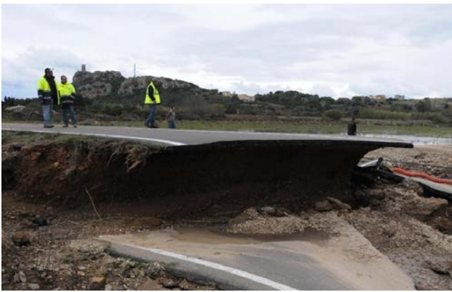
Figura 5: Rottura della pavimentazione stradale
