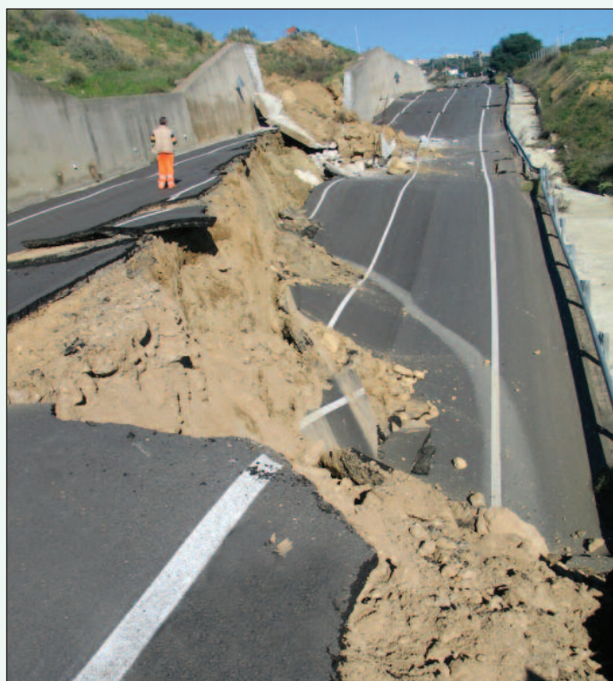
1. Danni provocati dalla frana nel comune di Montescaglioso (MT) il 3 Dicembre 2013
