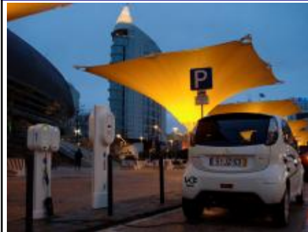
Colonnine per i veicoli elettrici in Portogallo
