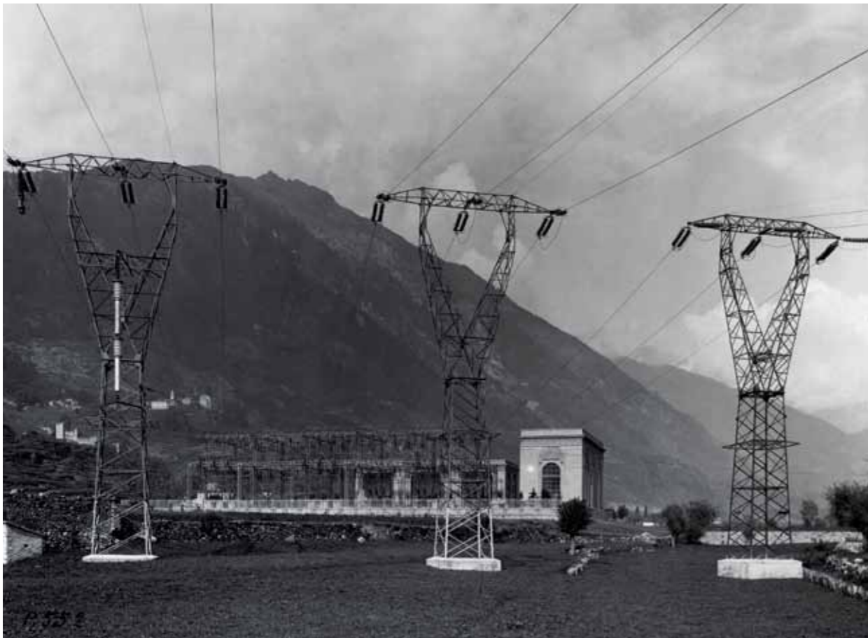
Impianto di Grosotto: partenza delle linee Valtellina e Valcamonica (foto di A. Paoletti, 1934, Archivio fotografico Fondazione AEM)
