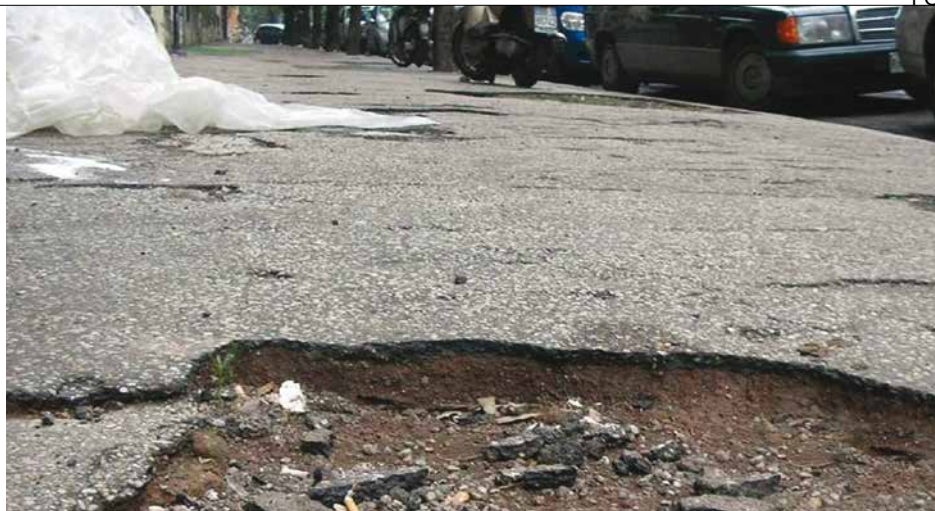
2. Un esempio di inesistente manutenzione ordinaria
