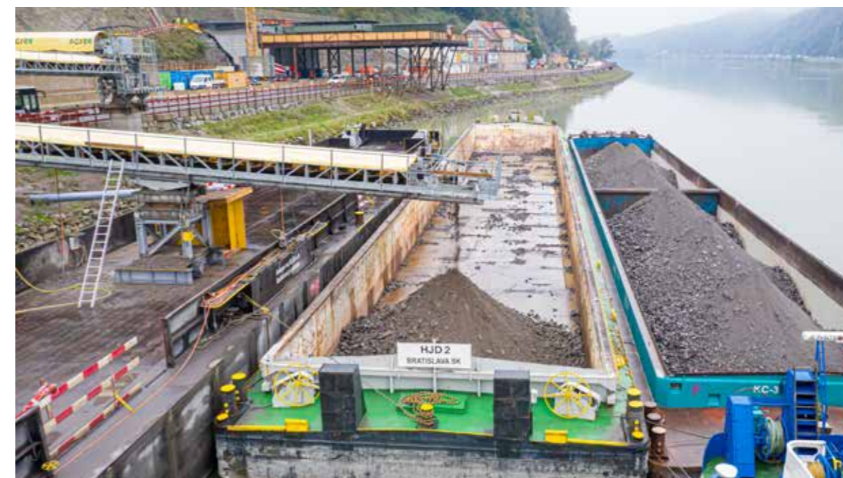
Allontanamento del materiale di scavo del tunnel attraverso l'utilizzo di una chiatta collocata sulla sponda Sud del Danubio
