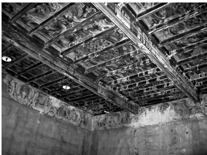
Solaio con decorazioni settecentesche nella stanza detta Caminata al terzo piano su via Giustiziati. Le decorazioni settecentesche del solaio (la cui struttura è cinquecentesca) sono in fase con il fregio a parete dipinto da Giuseppe Cadioli nel 1754
