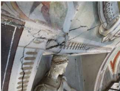
E fessurazioni, fratture e mancanze
