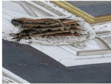
B caduta dell'intonaco della volta
