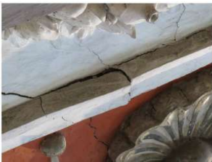
G fratturazioni e fessurazioni apparato decorativo in gesso
