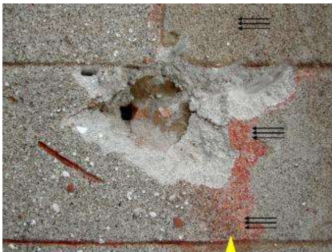
FIGURA B. In prossimità del foro lasciato dall'infissione e successiva rimozione di un perno è possibile considerare la modalità di esecuzione della finitura a finto mattone. Il triangolo giallo evidenzia una lacuna dello strato di finitura relativo alla giornata di destra che mette in luce le tracce della tinta rossa stesa nel corso della precedente giornata di sinistra. La tinta rossa è qui sopravvissuta grazie alla protezione dello strato soprappeso, fino a quando questo è venuto meno per la rimozione del perno. La tinta rossa è invece perduta per dilavamento sul resto delle superfici e sopravvive solo nelle incisioni che simulano i giunti.
