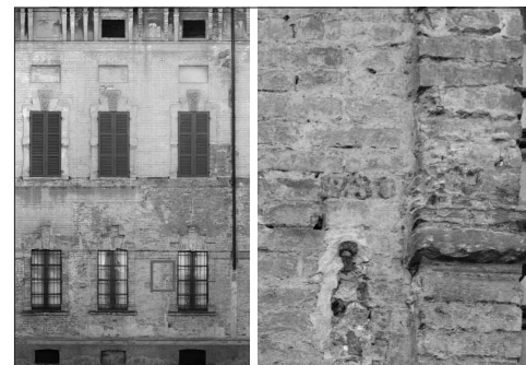
140. Il numero di serie di un fanale a gas, installato per l'illuminazione della via dopo il 1861 è tracciato direttamente sulla superficie del mattone, indicando come questa zona del prospetto fosse già priva dell'intonaco a quell'epoca.
