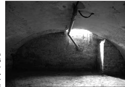
137. Nella grande cantina corrispondente al salone del piano nobile, la parete nord sotto la facciata risulta traslata verso la strada di oltre un metro, laddove corrisponde una porzione di volta a botte separata dalla preesistente da un giunto di fabbrica.
