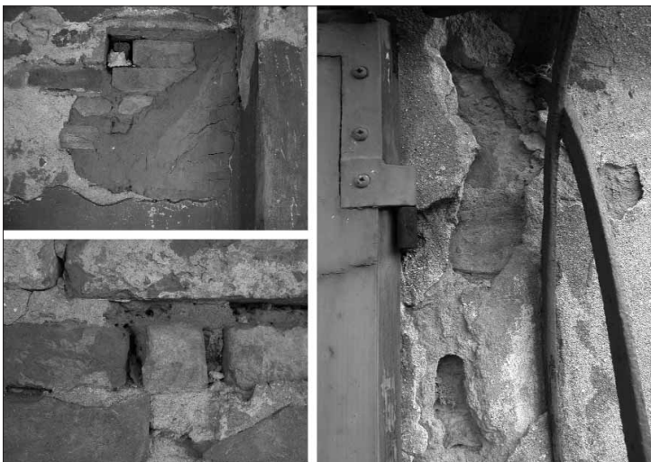
141. L'argilla compare come costituente di quasi tutte le malte da intonaco presenti sulla facciata di palazzo Magio Grasselli e delle malte di allettamento, dove è impiegata per legare murature di mattoni cotti e crudi.
