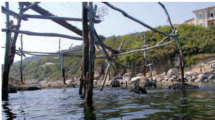
Foto 26 parte fuori servizio della passerella del trabucco di Punta Turchino da una foto del 2003 prima del crollo del 2014
