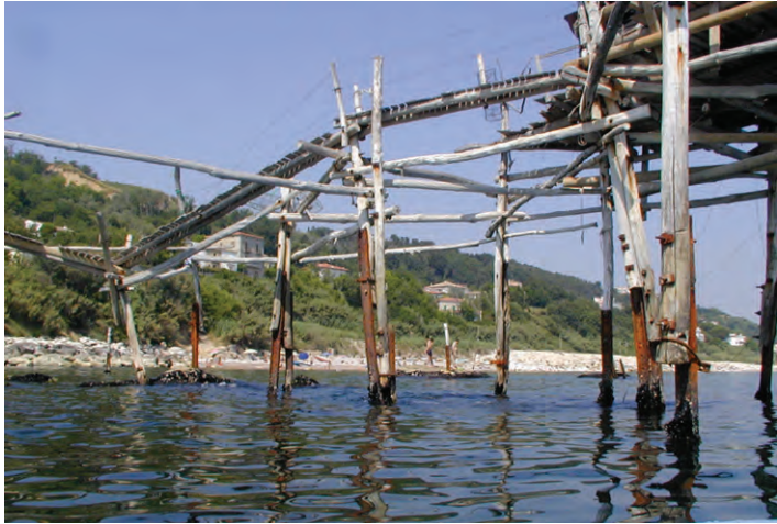
Foto 16 il cedimento della passerella in questo punto non pregiudica il funzionamen to del resto della struttura
