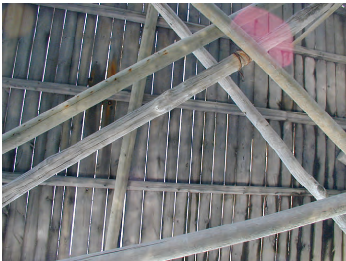
Foto 28 telaio della piattaforma del trabucco di Punta Turchino visto dal basso - foto del 2003 prima del crollo del 2014
