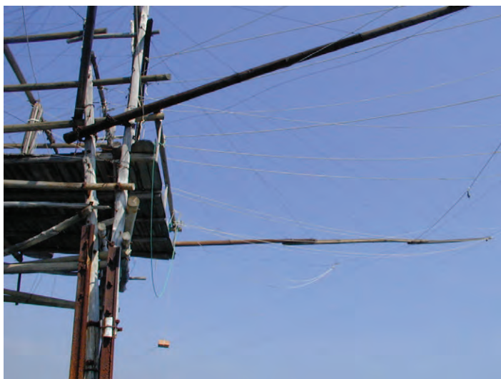
Foto 30 tiranti che sorreggono le antenne del trabucco di Punta Turchino da una foto del 2003 prima del crollo del 2014
