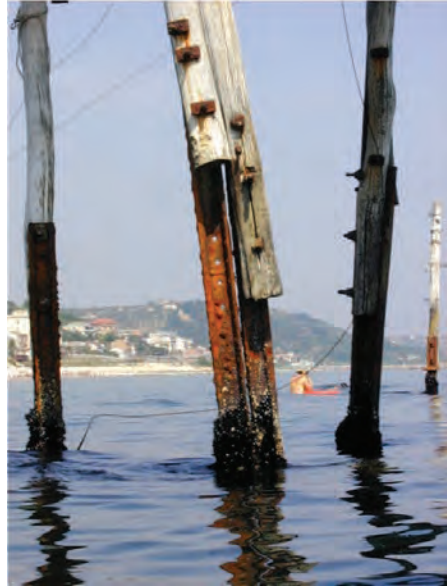
Foto 10 fondazioni del trabucco di Punta Turchino a San Vito (CH) Turchino da una foto del 2003 prima del crollo del 2014
