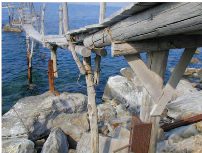
Foto 14 fondazioni della passerella del trabucco di Punta Turchino a San Vito (CH) Turchino da una foto del 2003 prima del crollo del 2014
