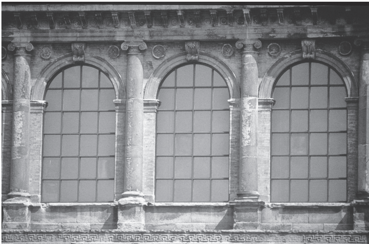
Fig. 2 - München, Alte Pinakothek, facciata Sud prima dei restauri (foto dell'autore, settembre 1993).
