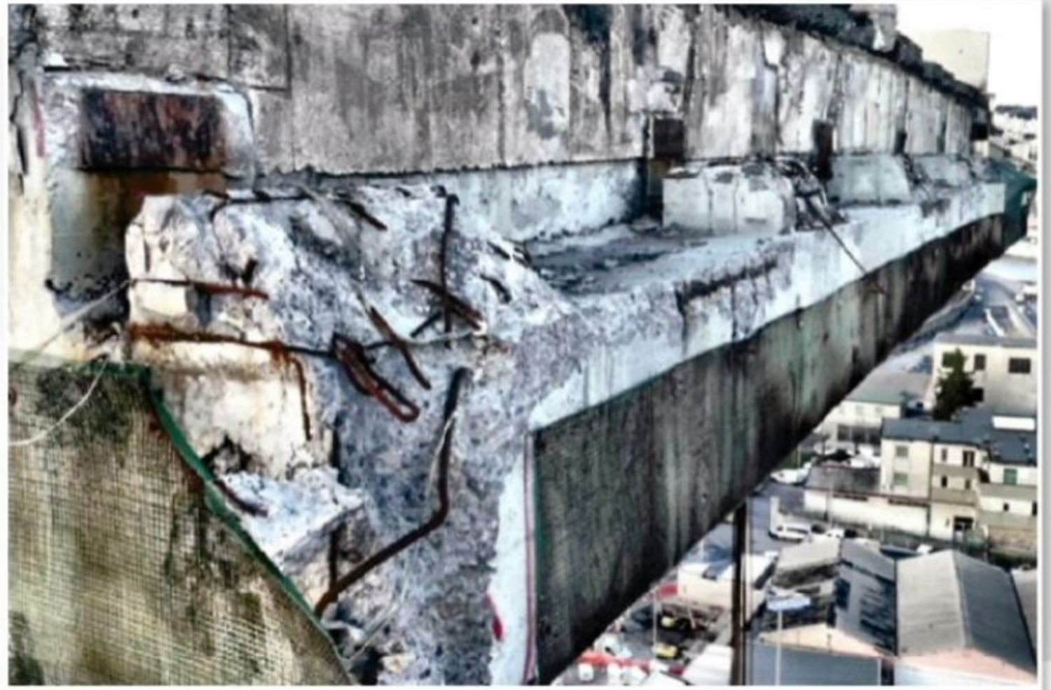
Desprendimiento de la cubierta de hormigón, carbonatación y oxidación de los refuerzos.
