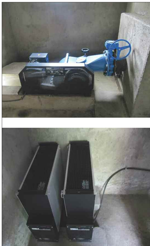
Figura 3 Blocco turbina e generatore – Resistenze zavorra.
