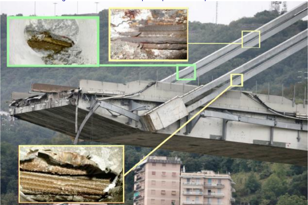
Figure 4 [Source Spea Engineering - Janvier 2016] Investigations diagnostiques sur les haubans des piles 9 et 10. Les carottes réalisées montrent une oxydation dans les torons, une corrosion et une rupture des câbles précontrainte. La gaine protectrice est oxydée à l'intérieur. Corrosion du lien interne dans le hauban de la pile 10. La carotte examine uniquement l'armure secondaire [Note 3].
