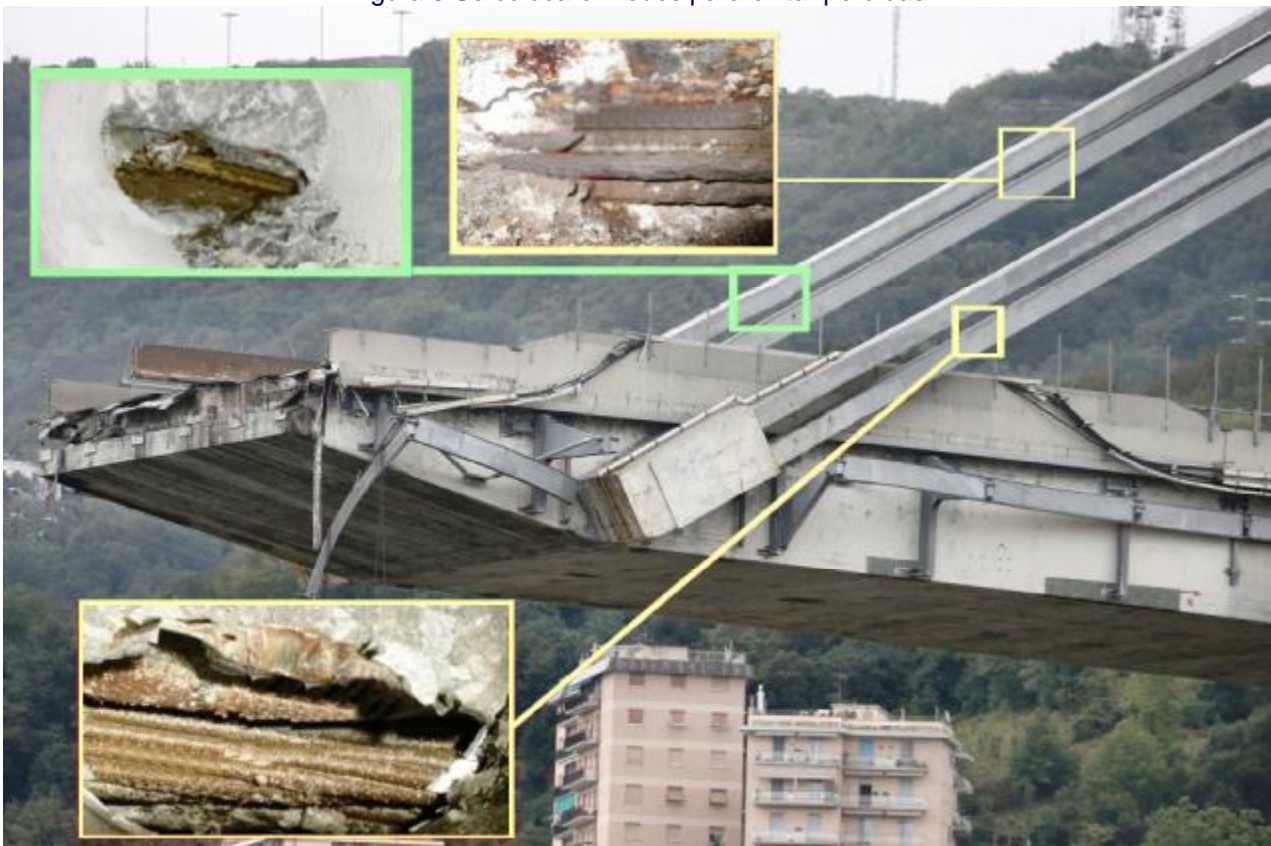
Figura 4 [Fuente: Spea Engineering - enero de 2016] Investigaciones de diagnóstico sobre las estancias de las pilas 9 y 10. Los núcleos realizados muestran una oxidación en los hilos, una corrosión y una ruptura de los cables pretensados. La funda protectora se oxida en el interior. Corrosión del lazo interno en el puntal de la pila 10. El núcleo examina solo la armadura secundaria [Nota 3].
