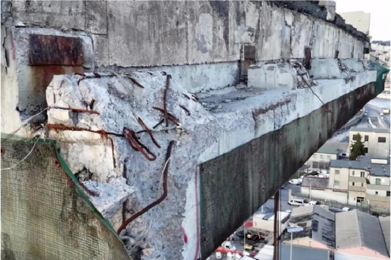
Figura 2 Desprendimiento de la cubierta de hormigón, carbonatación y oxidación de los refuerzos.
