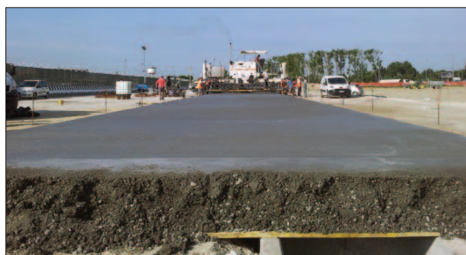
1A e 1B. La stesa di pavimentazioni in calcestruzzo mediante tecnologia slipform
