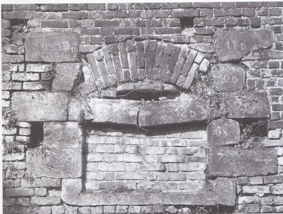
FIG. I - Particolare della finestra di destra del prospetto meridionale del rivellino, ricostruita dopo essere stata smontata per consentire la realizzazione del tunnel della MM1. Sono ancora visibili i numeri a suo tempo tracciati con la pittura per individuare e ricomporre i conci lapidei una volta ultimati i lavori per il tunnel.
