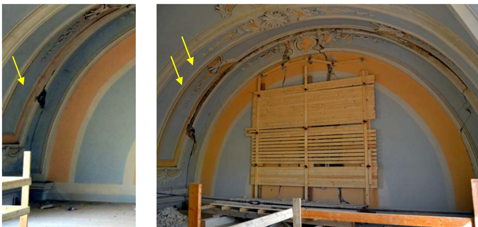
Figura 2 – Progressione del danno
