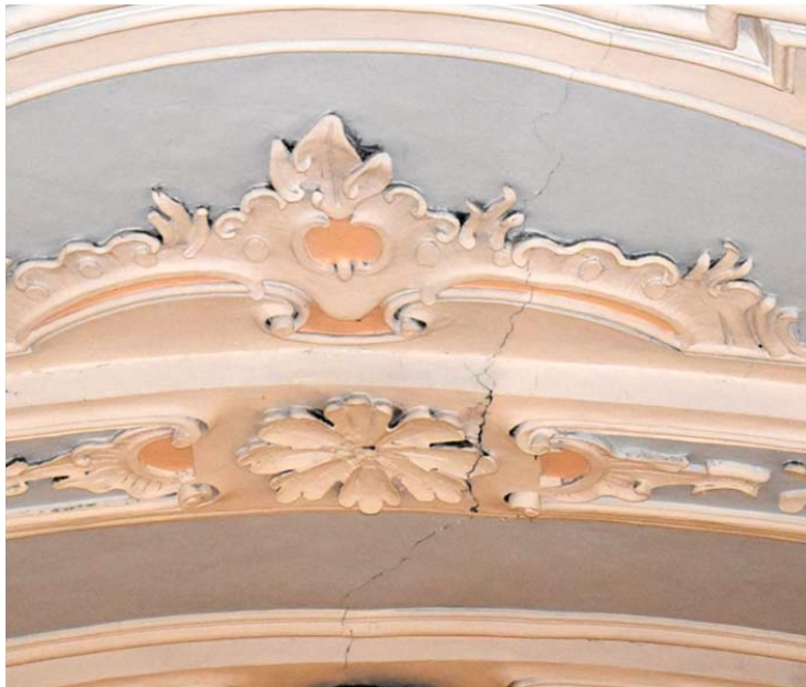
Figura 5 – Fessurazione in sommità di una volta
