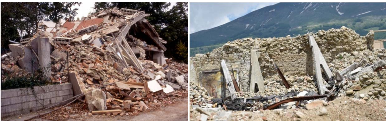
Figura 1 – Collasso delle strutture di copertura: a sinistra, Cesi, terremoto di Umbria-Marche 1997, a destra Amatrice, terremoto del Centro Italia 2016
