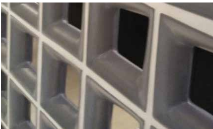
FIGURA 20: Elementos vazados em cerâmica
