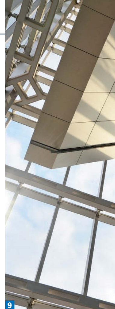
Immagine 9 (a destra). Applicazione del sistema di involucro alle interfacce angolari: rapporto strutturale con il telaio principale e con gli aggetti interni
