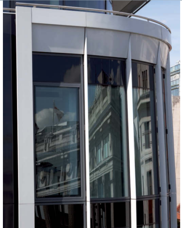
Costruzione e modulazione dell'involucro: interfaccia tra le tipologie di chiusura e le sezioni di rivestimento
