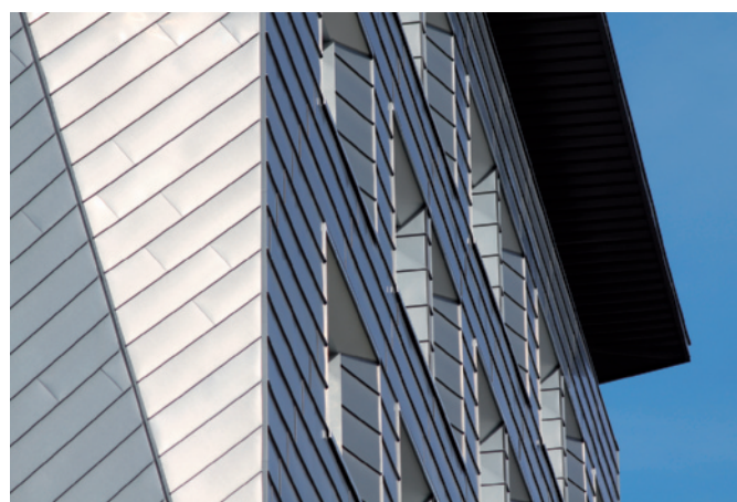
Applicazione delle superfici finestrate: inserimento delle sezioni di imbotte secondo il taglio diagonale del rivestimento sull'apparecchiatura muraria
