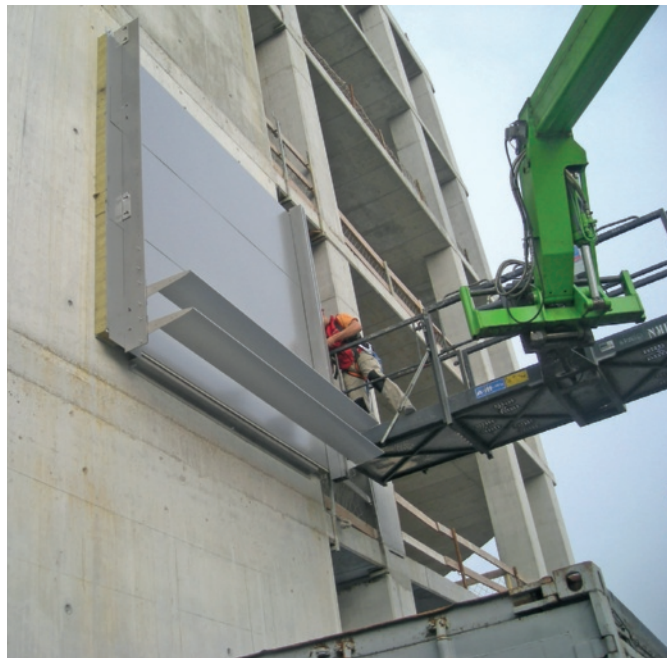
Immagine 11. Sequenza di posa dei moduli di rivestimento, provvisti delle marcature orizzontali composte dagli elementi frangisole, per le superfici verticali opache riferite ai vani tecnici e di collegamento
