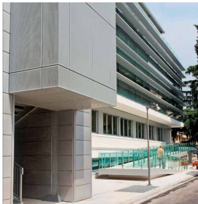
Immagine 4. Applicazione del sistema di facciata strutturale: montaggio delle chiusure in vetrocamera e innesto del supporto ai dispositivi frangisole
