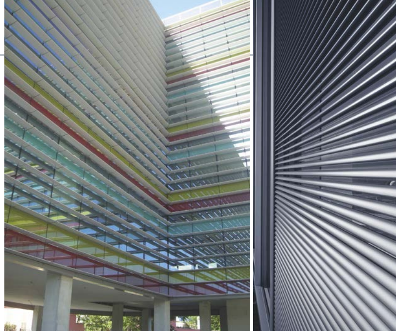
A sinistra. Installazione esterna fissa dei dispositivi frangisole orizzontali "passivi", eseguiti rispetto al Colour Building a Milano, progettato da Giancarlo Piretti
