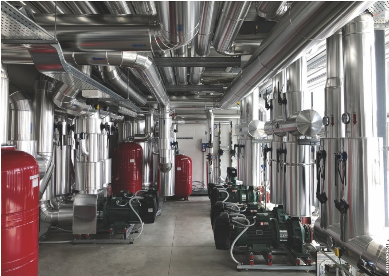
Vista della centrale termica di generazione del calore localizzata al piano seminterrato View of the energy centre in the basement
