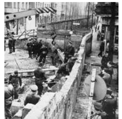
1961 Il 13 agosto, la Repubblica Democratica Tedesca inizia i lavori di costruzione del Muro di Berlino/ The German Democratic Republic started building the Berlin Wall on 13 August
