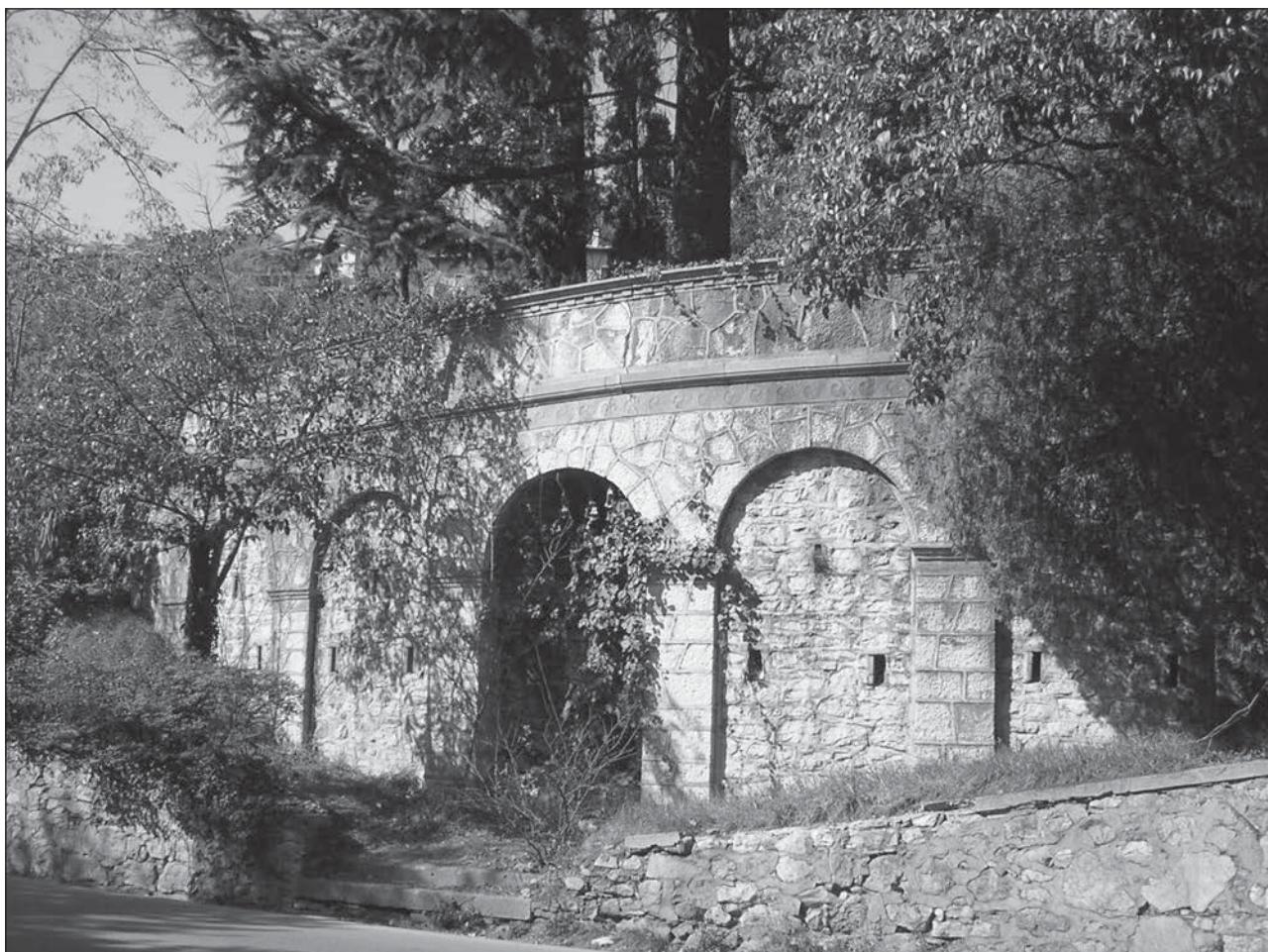
Fig. 12. Il monumentale parco delle Rimembranze di Salò (BS) oggi in stato di abbandono e di grave degrado risulta anche danneggiato da interventi di trasformazione delle infrastrutture viarie ad esso adiacenti.
