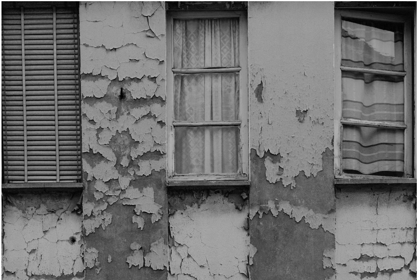
Il degrado architettonico della facciata di un edificio interno al quartiere San Siro di Milano in una fotografia scattata nel 2016.
