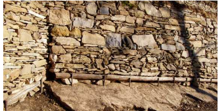
In presenza di ampie rocce superficiali, un palo di legno ancorato alla roccia madre aiuta a individuare un piano di appoggio del muro e impedisce lo slittamento delle pietre sulla roccia madre
