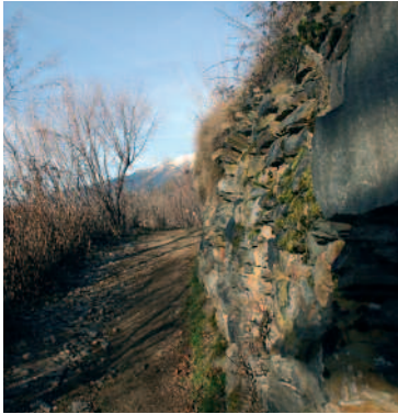
Crollo di porzione di muro
