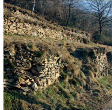
Crollo di porzione di muro
