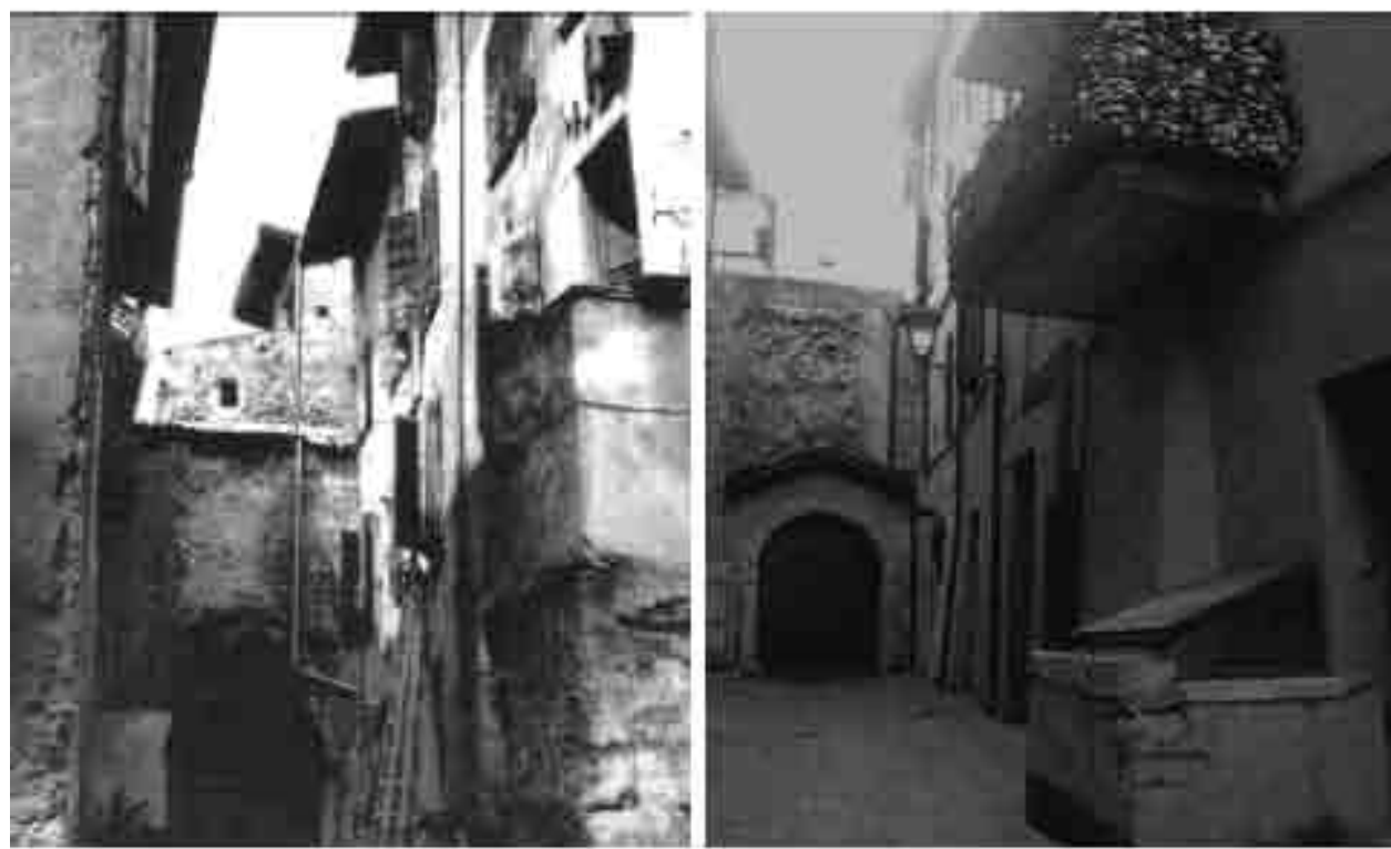
Figure 7-8: Salò: corpo aggiunto, muratura disarticolata. Contrafforti lungo la parete verso valle.
