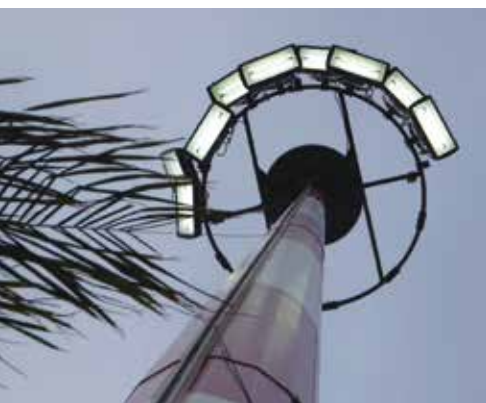
5. Un torrefaro con lampade ad induzione presso un aeroporto in Marocco
