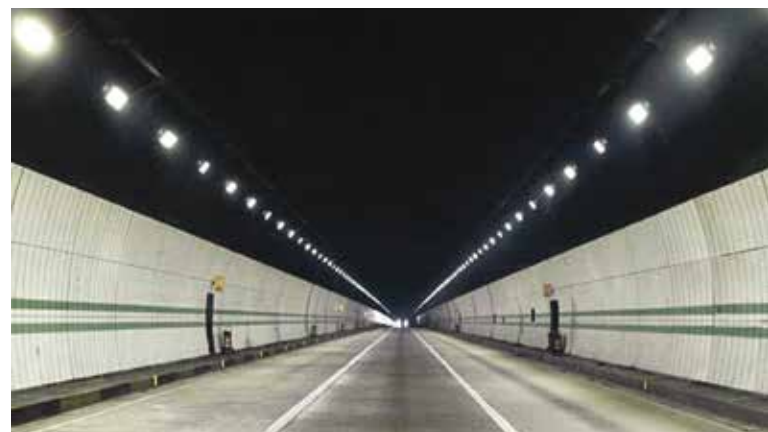
3. Un esempio di illuminazione ad induzione in un tunnel
