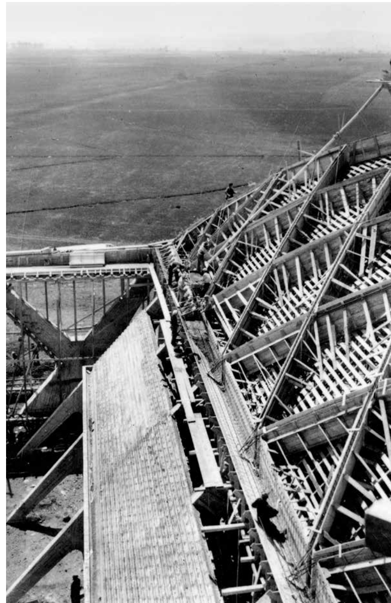
10. Aviorimessa di Orvieto, cantiere, dettaglio di carpenteria e casseri della copertura. Studio Vasari, Roma, [1936]; CSAC, Università di Parma.
