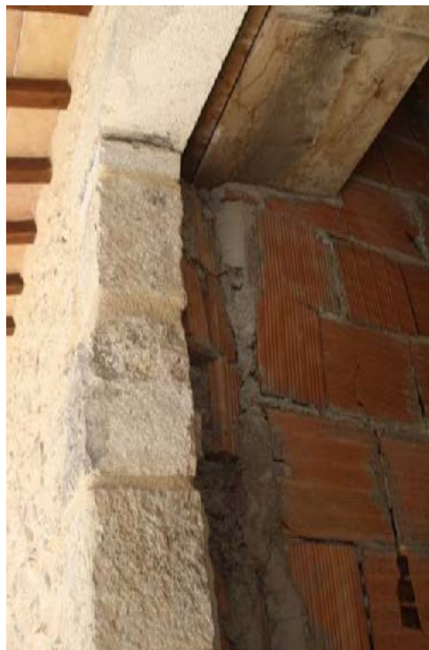
Figura 8. Particolare dello spessore del paramento esterno in muratura di pietra realizzato con il riutilizzo delle pietre e cornici dello stesso edificio e ancorato alla nuova struttura portante.
