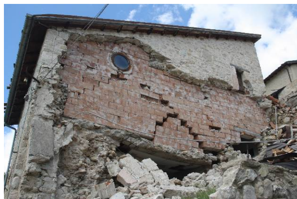
Figure 9. In questo edificio il paramento esterno ricostruito in pietra si è staccato, denunciando il collasso della muratura nuova retrostante, appoggiata sopra una muratura più antica che ha ceduto (UMI 14).
