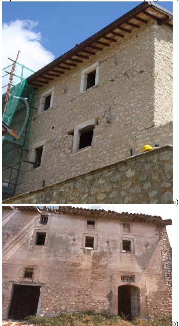
Figura 7. Edificio UMI 27, a) situazione attuale dell'edificio ricostruito e seriamente danneggiato con lesioni orizzontali e diagonali, b) edificio nel 1999 danneggiato dopo il sisma del '79 e del '97, successivamente riparato con ricostruzioni in muratura portante in forati e solai in latero-cemento.
