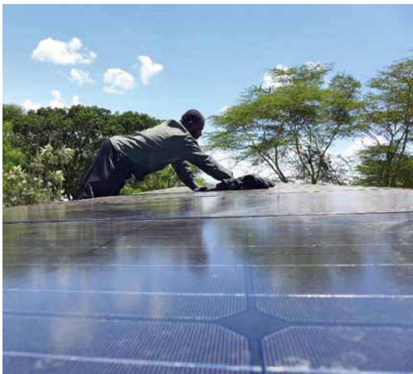
Impianto Fotovoltaico installato nella scuola Photovoltaic system installed in the School
