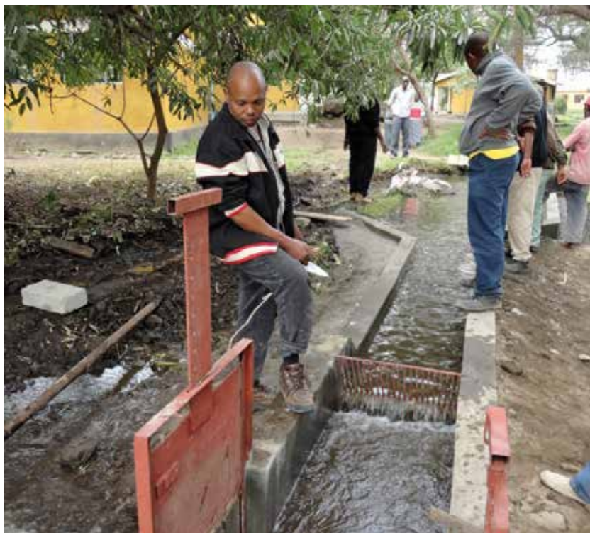
Pres di adduzione della turbina idroelettrica installata nella scuola Water intake of the hydroelectric turbine installed in the school
