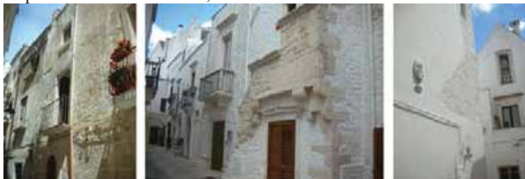
Fig.-2 - Locorotondo (BA): nucleo antico. Interventi impropri sulle cortine edilizie decornate, scialbate a calce, velate a calce con pigmento, “lacune perdita”.
