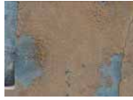
Fig. 18 - Degrado graduale della finitura gialla che evidenzia il sottofondo grigio cementizio (XXI sec.).
