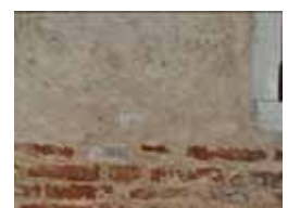
Fig. 41 - Nuovo intonaco in cocciopesto a superficie grezza con spessore che si riduce nel piano terra.
