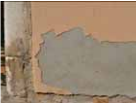
Fig. 16 - Degrado repentino per distacco della finitura rosata che evidenzia il sottofondo grigio cementizio (XXI sec.).
