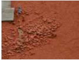
Fig. 17 - Degrado repentino che prelude al distacco della finitura a colore rosso (XXI sec.).
