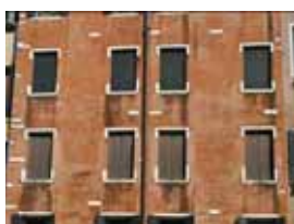
Fig. 26 - Evidenziazione impropria di conci lapidei e 'taglio' delle cornici delle aperture (XXI sec.).
