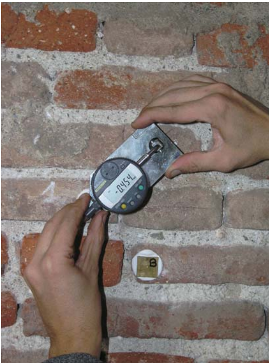
Fig. 5. Torre dei Masserano: metodo di monitoraggio basato su una terna di punti, fissati da piastrine quadrate in acciaio inox posizionate a cavallo della lesione.
