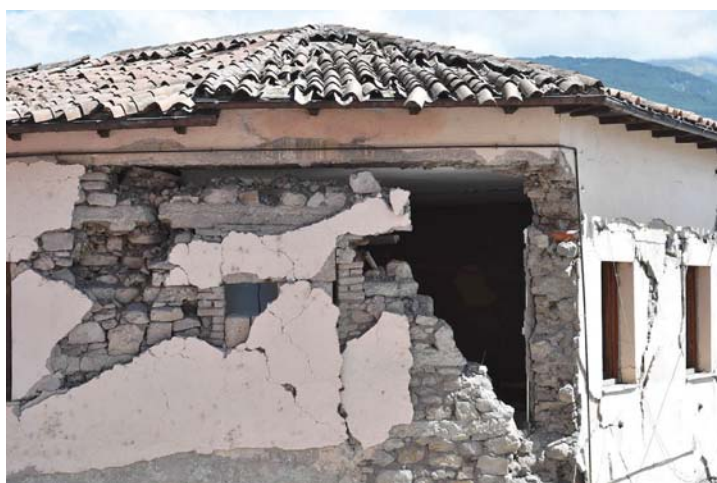
Fig. 1. Edificio danneggiato dal sisma, che ha colpito il centro Italia nell'agosto 2016, con evidenti segni di trasformazioni, discontinuità murarie e sostituzioni di copertura che lo hanno reso maggiormente vulnerabile (da < www.ilpost.it > [15/12/2016]).
