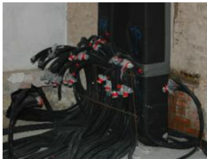
1. L'imbarazzante ed ingombrante presenza della distribuzione impiantistica all'interno di un edificio.
