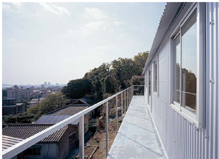
Fig. 14 - Casa a Rokko - Vista del rivestimento esterno in lamiera d'acciaio zincato e del balcone d'acciaio in aggetto
