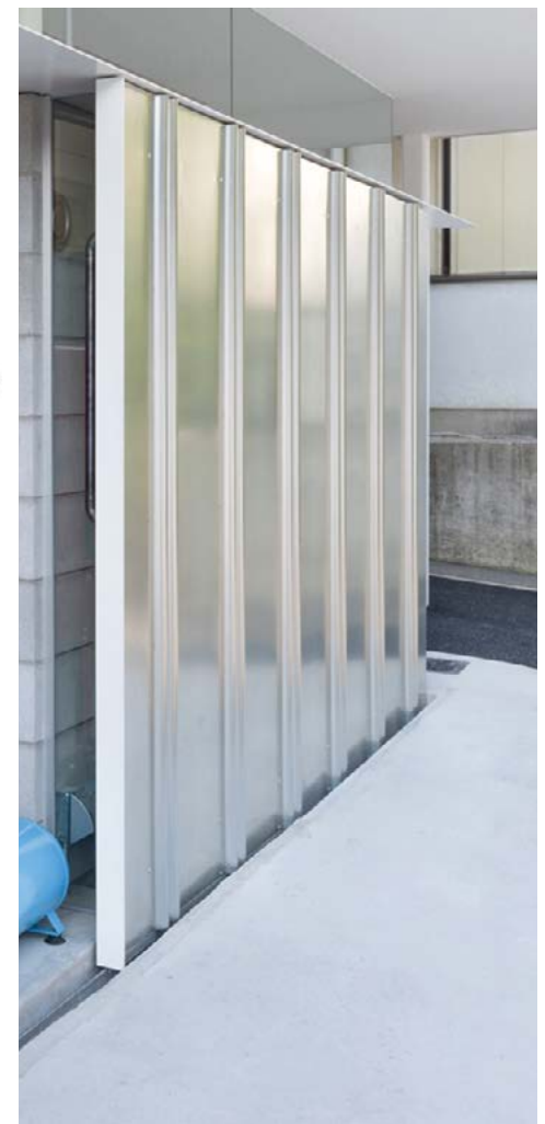
Fig. 31 - Casa a Kawanishi - Dettagli chiusura scorrevole in lamiera d'acciaio zincato al piano terra
