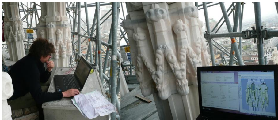
Fig. 5 - Utilizzo del BIM in cantiere durante le operazioni di sostituzione dei conci ammalorati.
