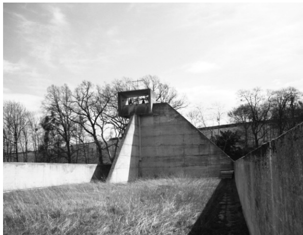
Fig. 7. Convento di Sainte-Marie de la Tourette, muro in calcestruzzo armato che cinge il tetto-terrazza della chiesa. Gettato senza giunti, il muro presenta lesioni verticali a intervalli regolari [foto dell'autore, 2010]
