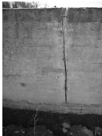
Fig. 8. Convento di Sainte-Marie de la Tourette, muro di recinzione del tetto terrazza della chiesa, lesione iniettata con schiuma poliuretanicca, sigillata con resina epossidica e parzialmente 'cucita' con elementi metallici, durante i lavori di restauro del 1981 [foto dell'a., 2010]
