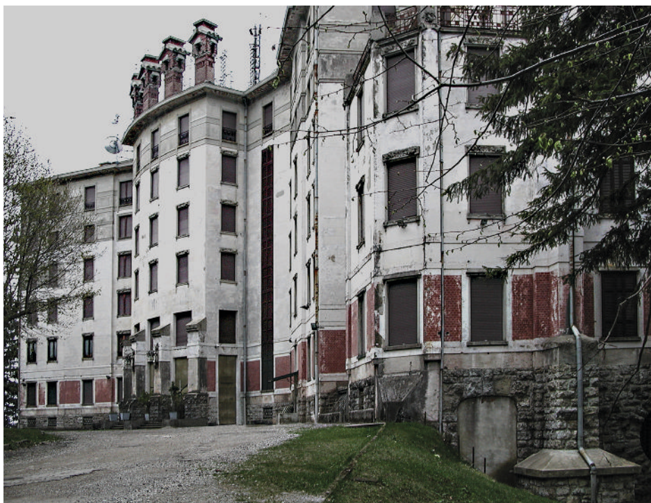
10. Veduta del fronte verso monte del Grand Hotel. È evidente lo stato di degrado. Foto dell'autore 2007.
