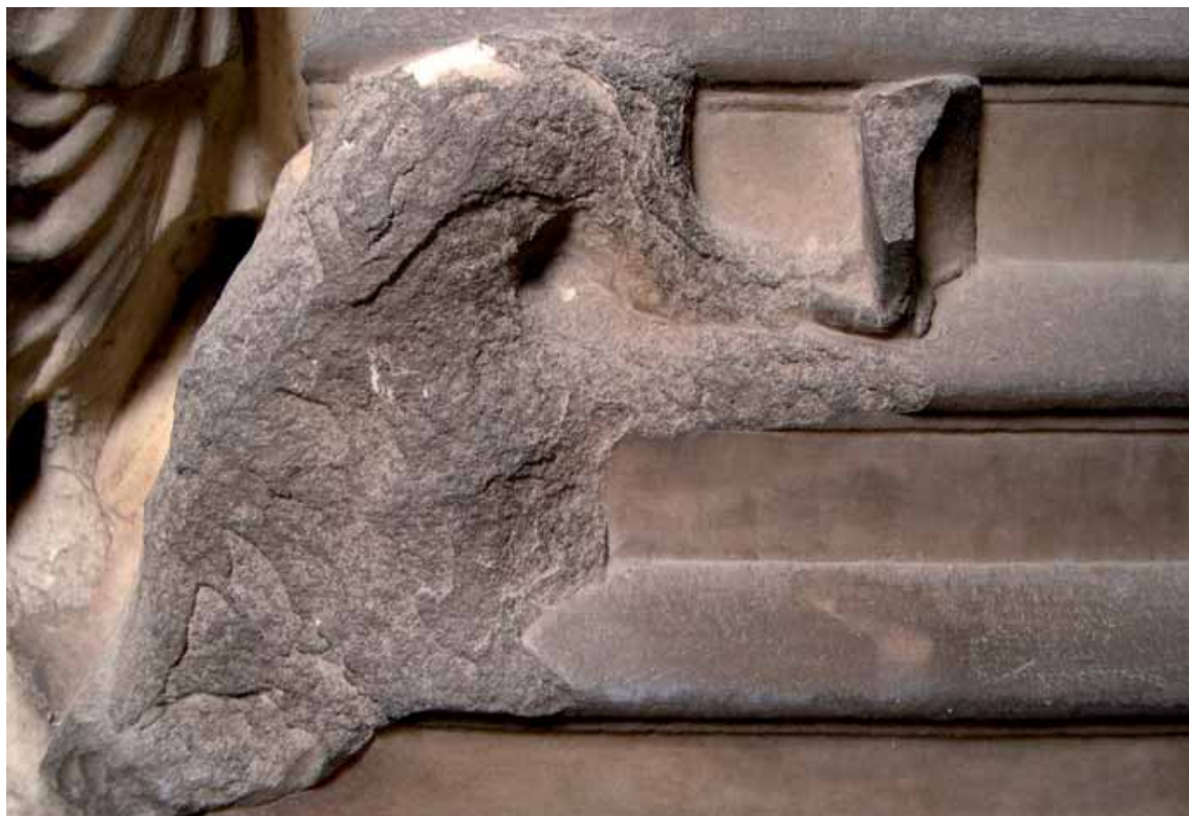
Fig. 10. Altare della Presentazione: gli elementi realizzati in marmo di Carrara si presentano un degrado molto accentuato dovuto alla presenza di sali solubili all'interno della porosità. Le zone più rovinate sono quelle subito a contatto con il cemento delle stuccature e quelle più aggettanti, già traumatizzate in fase di lavorazione e intrinsecamente più deboli.
