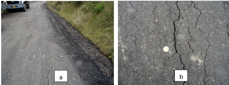
Figura 6. Dommages observés dans les routes construites en matériau de fraisage. (a)Échec de la saturation en bordure de route par manque de caniveau. (b) détail de la fissuration longitudinale par saturation.
