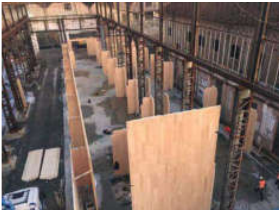
Fig. 4.25: Realizzazione della struttura portante verticale sopra una fondazione continua di calcestruzzo ad Allodi (ex Officine Reggiani).
