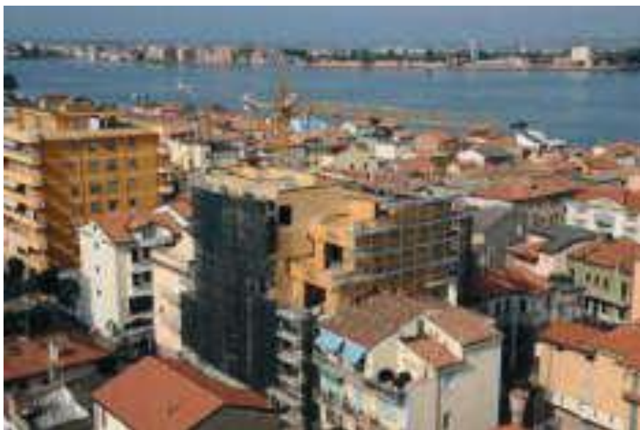
Fig. 4.28: Cantiere di un complesso residenziale a Chioggia (VE). Fonte: X-Lam Dolomiti S.r.l.
