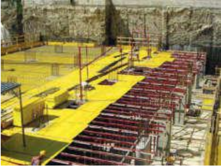
Fig. 4.11: Il sistema “Alumecano”: 3 giorni dopo il getto, il sistema consente di recuperare il 100% dei pannelli e il 50% dei puntelli. (cantiere uffici via Darwin, Milano).
