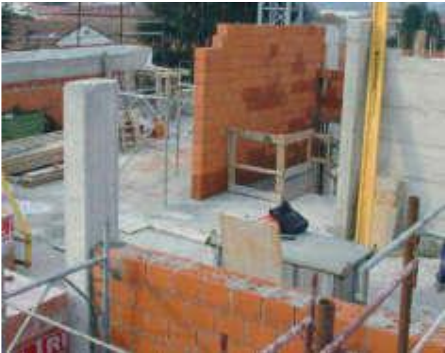
Fig. 4.2: Sistema costruttivo tradizionale: realizzazione dei tramezzi interni, dei pilastri e delle murature di tamponamento esterne.
