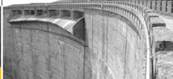
Centrale idroelettrica Providenza AQ
