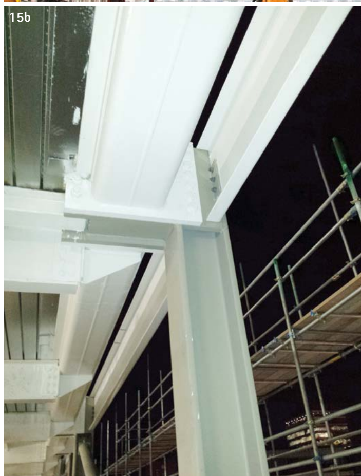
Figg. 15a, 15b – Viste del cantiere nella fase di montaggio della struttura a tre piani della copertura curva, in cui si evincono i dettagli di connessione tra la struttura sottostante e la trave anulare scatolare che corre lungo tutto l'edificio. (©Watermann Group)
