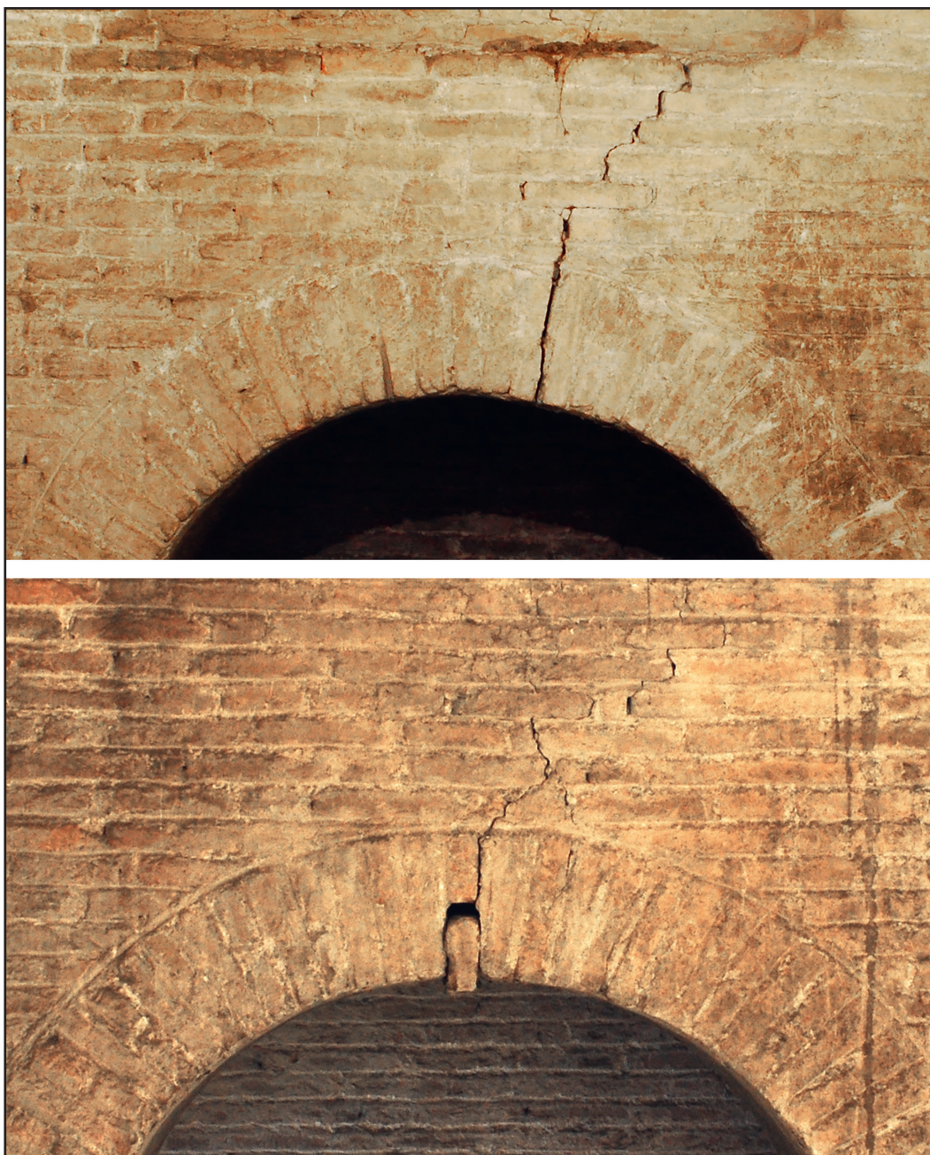
Figura 1. Lesioni ad andamento inclinato presso le arcate interne del fronte sud-est del campanile dei Gesuiti (foto di M. Ganz).
