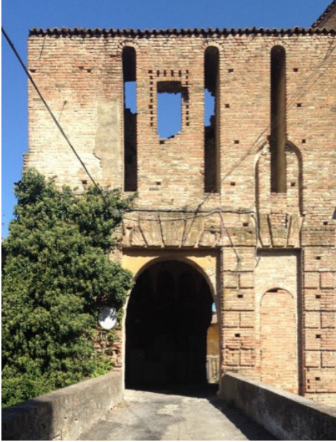
Fig. 8- Il “portale” e la “pusterla pedonale” murata, e le tracce di alloggiamento dei bulzoni dei due ponti levatoi (foto di Michela Marisa Grisoni, 2020)
