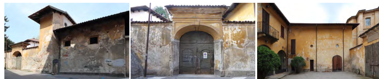
Fig. 4-5-6 - Il pesante degrado in cui versavano i rivestimenti esterni, ma anche interni dell'edificio realizzati a più riprese ed in buona parte in malta cementizia.
